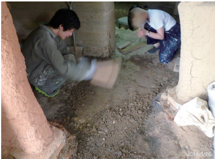
入口付近は特にバラスが厚く堆積していて、こそげると凹凸が激しい。三和土は二層にする。
