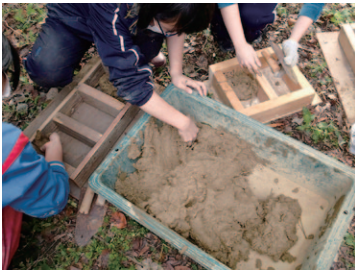
土練り機で、土塀の土と床を掘って出た土(真砂土に近い)を混ぜて捏ねる。両者の比率は1:1。スサを入れて捏ね終わった土を型枠に移す。
