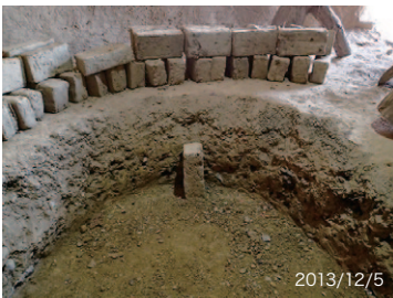
日干しレンガを並べ始める。レンガは斜め積みするので、それを受けるために、カーブの一番きつところから固定し始め、両側に広げていく。
