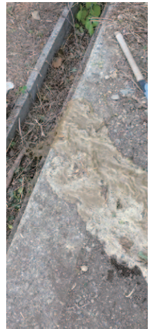
試しに水を流す。一筋の水の流れに歓声上がる。コンクリートの側溝は、沓掛キャンパス造成時に、丘の地形維持のためにつくられたと思われる。
