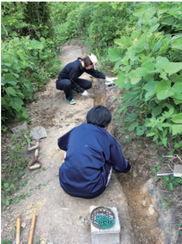
溝を掘る。道づくりの基本となる文字通り「地道」な作業。屋外の造形でもっとも重要なのは水の処理。水は、家であれ、道であれ、階段であれ、いつかすべてを破壊し尽くす。溝のない道はすぐに壊れる。溝自身もいつか崩れるので、メンテナンスが必要になる。
