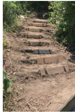
改良前の階段。横に溝がなく、これでは上を水が流れてすぐに壊れる。
