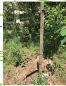
つちのいえに送電する電柱
