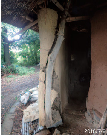
柱が束石からずれ、壁から半分遊離した。
