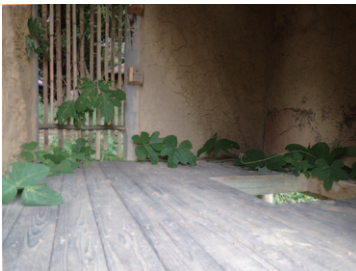
葛のツタが土浮庵に侵入している。
