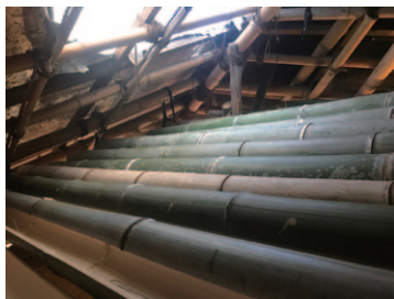
破れた布屋根の下の内屋根。
