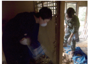
門屋の壁をカケヤで叩いて壁土を丁寧に落とし、土囊につめていく。土埃が舞い上がる。
