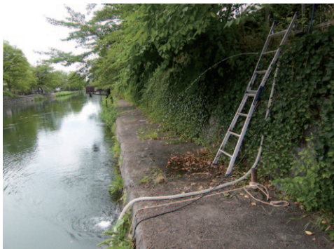
美術館横の琵琶湖疏水から直接水をポンプアップする。
