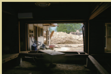
浸水した実家の後始末 (2011年9月紀伊半島大水害)
